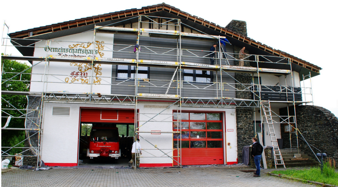
In der Sanierung befindet sich zurzeit die Eingangsseite zum Gemeinschaftshaus. Foto: Schropp
