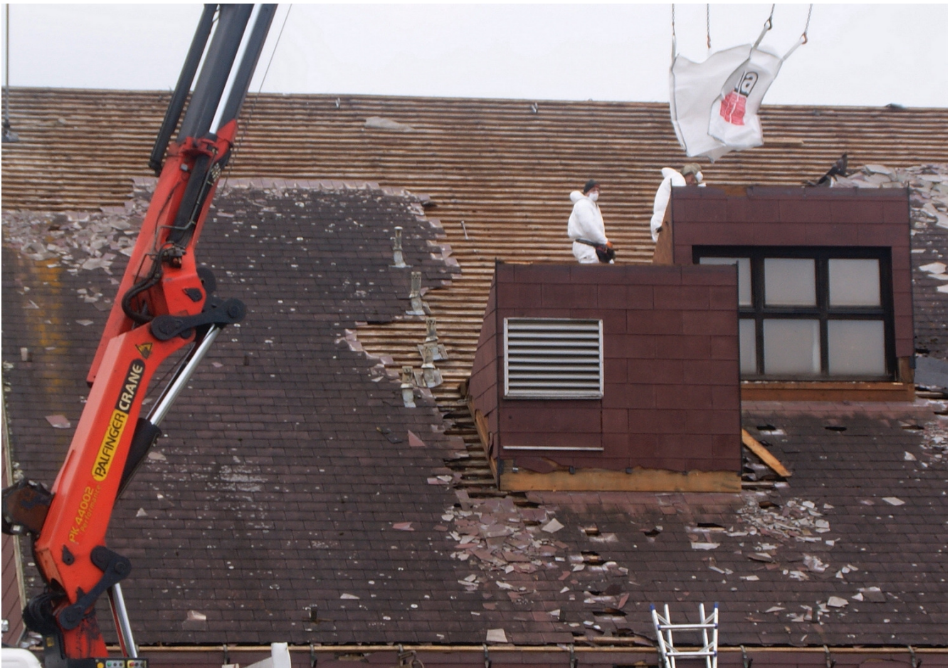
Die Abbrucharbeiten auf dem Dach des „Haus des Gastes“ laufen auf Hochtouren.
